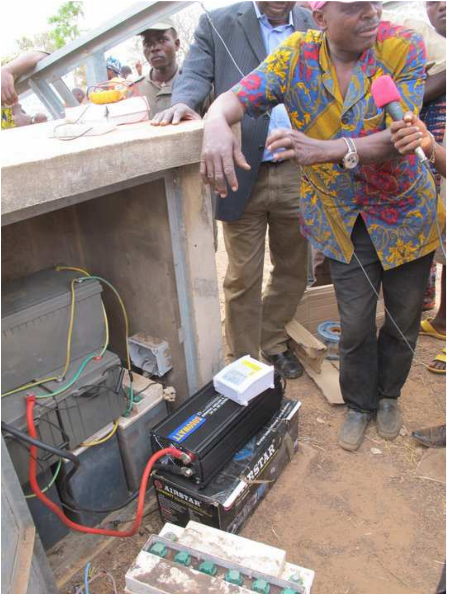
De nouvelles batteries solaires
